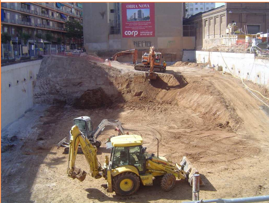
Foto 12. Solar ja totalment rebaixat durant l'eliminació de la rampa d'accés feta amb terres ja remogudes per la pròpia obra.
